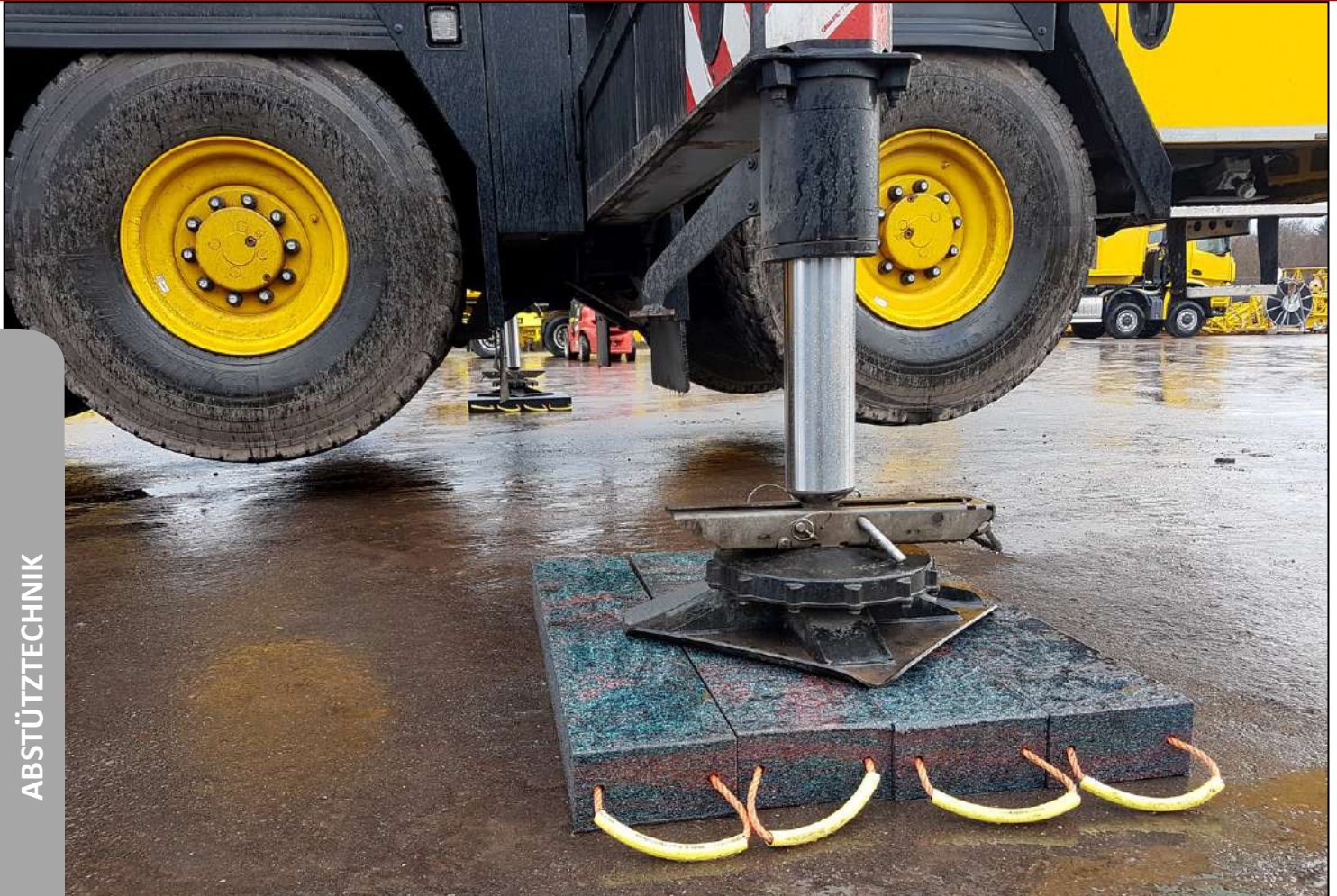
Kranbalken — mehr Infos auf Seite 50
